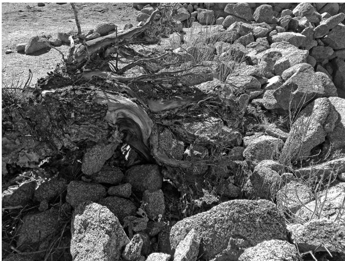
Figura 26: Raíz de cardón, se observa como al colapsar arrastró elementos líticos de un tramo de muro. Fotografía Amelia Pérez Trujillo.
